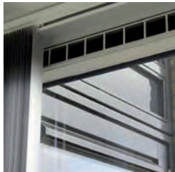
Ventilatierooster (bron: woningtotaal.nl)
