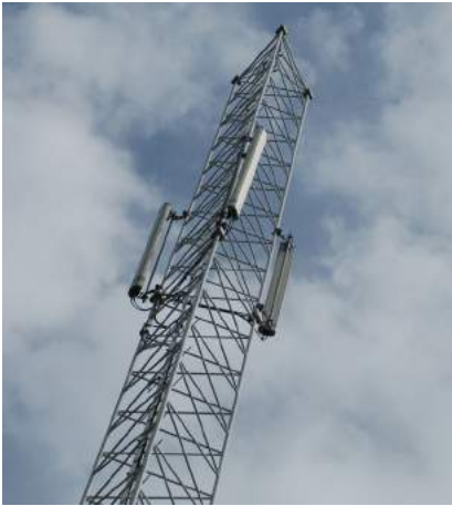
Mast mobiele telefonie
