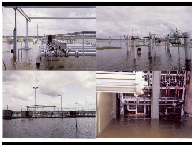
Overstroming van meet- en regelstations
