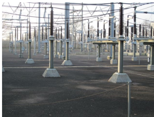
Transformatorstation bij Amersfoort
