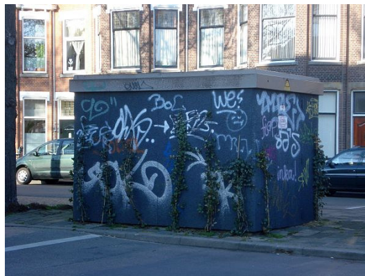
Transformatorhuisje in Den Haag
