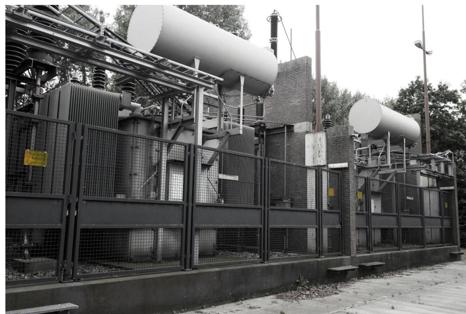
Afbeelding 4: Verhoogde 150 kV transformators (Tennet) aan de Baanhoekweg. Deze locatie kent in deze studie geen overstroomingsrisico's vanuit de rivier
