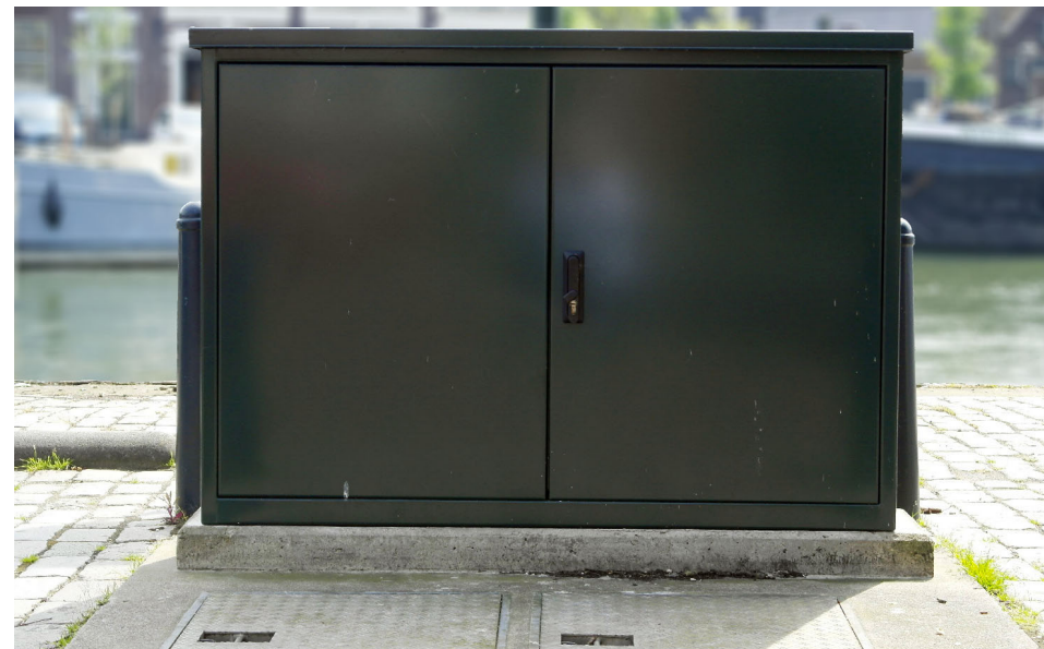
Afbeelding 5: Rioolgemaal aan de Binnen Kalkhaven. Het gemaal wordt uitgeschakeld bij een hoogwatermelding van 2 m + nap
