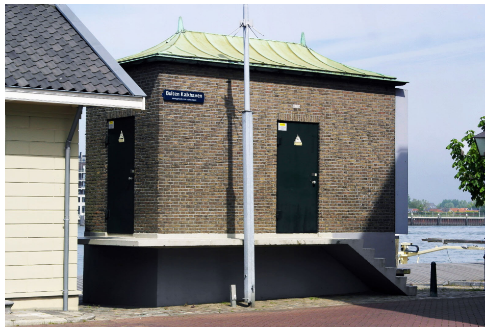
Afbeelding 3: Verhoogd 50 kV schakelstation (Stedin) aan Buiten Kalkhaven. Deze locatie is bij een maatgevende overstrooming circa 1 meter onder water. Het transformatorhuisje is ruim 1,2m verhoogd aangelegd.
