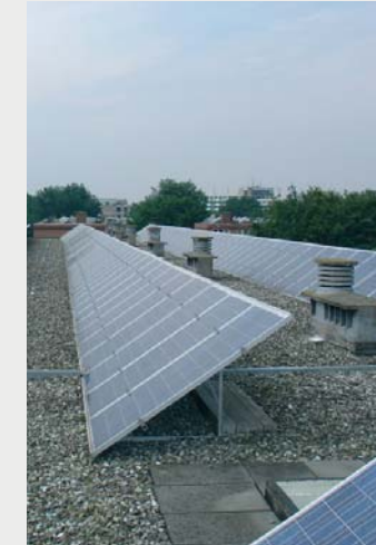
Zonnepanelen op complex De Aak in Amsterdam (De Alliantie)
