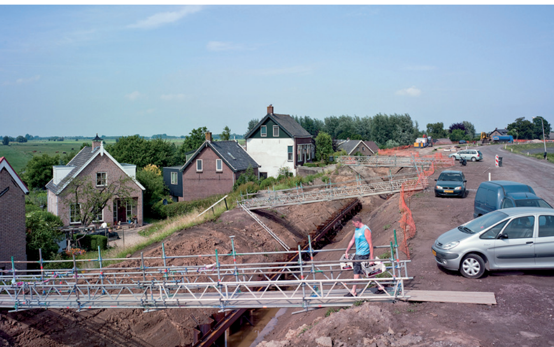
Dijkversterking aan de Lek
