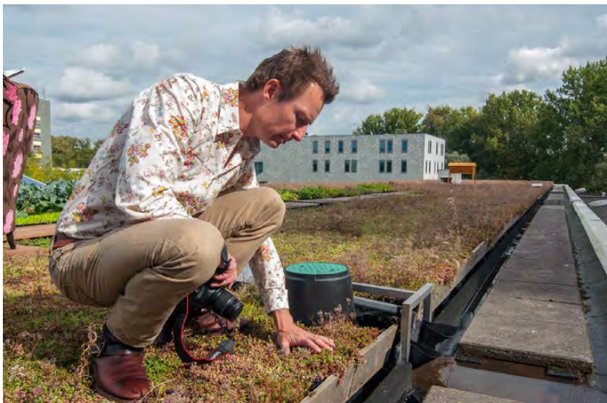
Een polderdak van Amsterdam Rainproof (2017), foto van Merlijn Michon.
